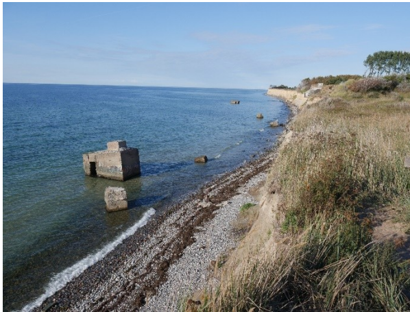
Abbildung 22: Küstenrückgang an der Steilküste südlich von Ahrenshoop (Elemente der ehemaligen Radarstation) (A.C. DE LA VEGA-LEINERT, 2022)
